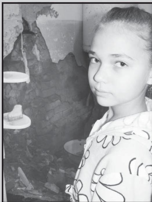
Девочка испытала сильный испуг, когда на нее стали падать куски штукатурки
