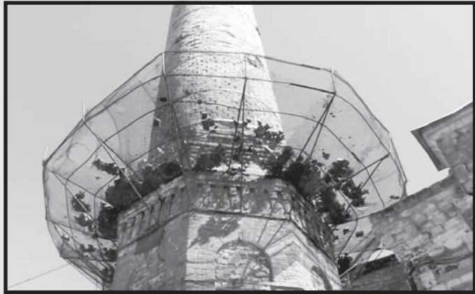
Сетчатый "зонт" - единственное препятствие между отваливающимися кирпичами и людьми
