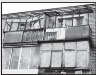
От мощного порыва ветра погнуло балконные ограждения и выбило стекла
