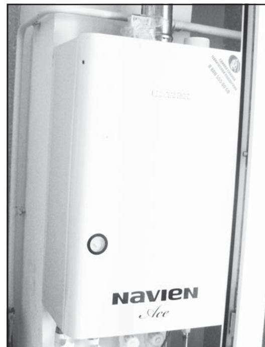
Установка этого котла обошлась в 48 тысяч рублей
