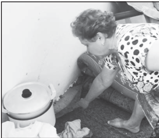
Вместо полов в квартире матери Л. Устюжаниной бетонные плиты
