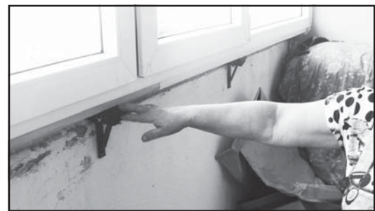
Строители не сделали ни откосов, ни подоконников
