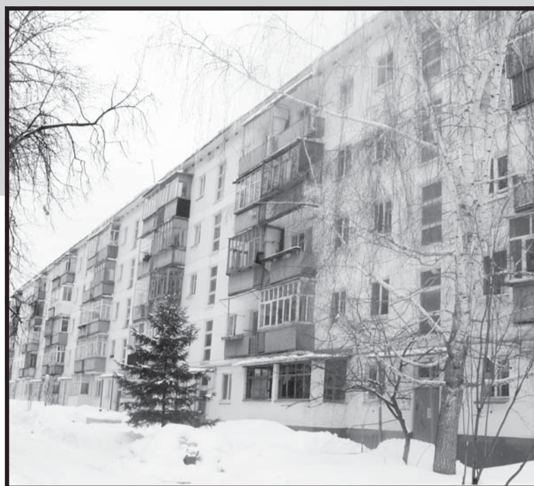
С приходом весны крыша дома напоминает сито
